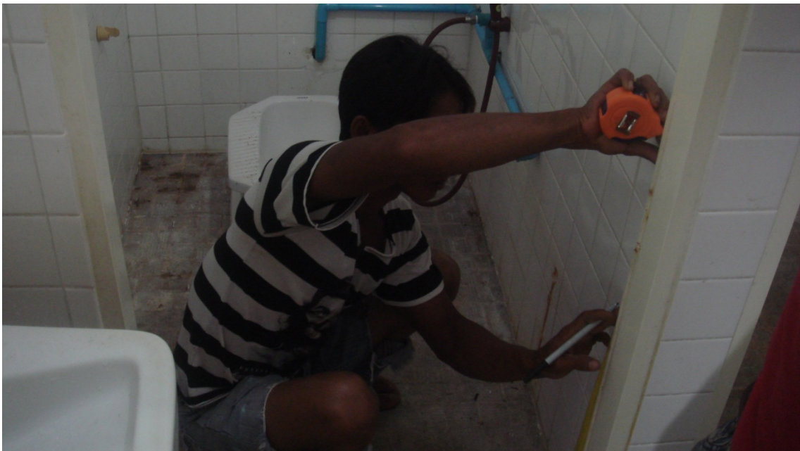
ภาพการซ่อมแซมอาคารสถานที่ให้มีสภาพมั่นคง และสวยงาม
